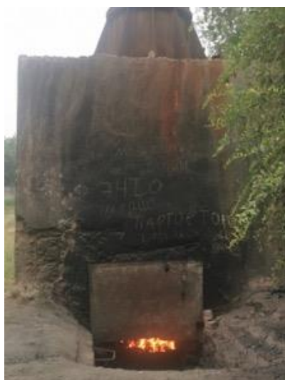
Фотография 16. Мусоросжигательная печь в РЦЗ/ЦРБ Шахритус
